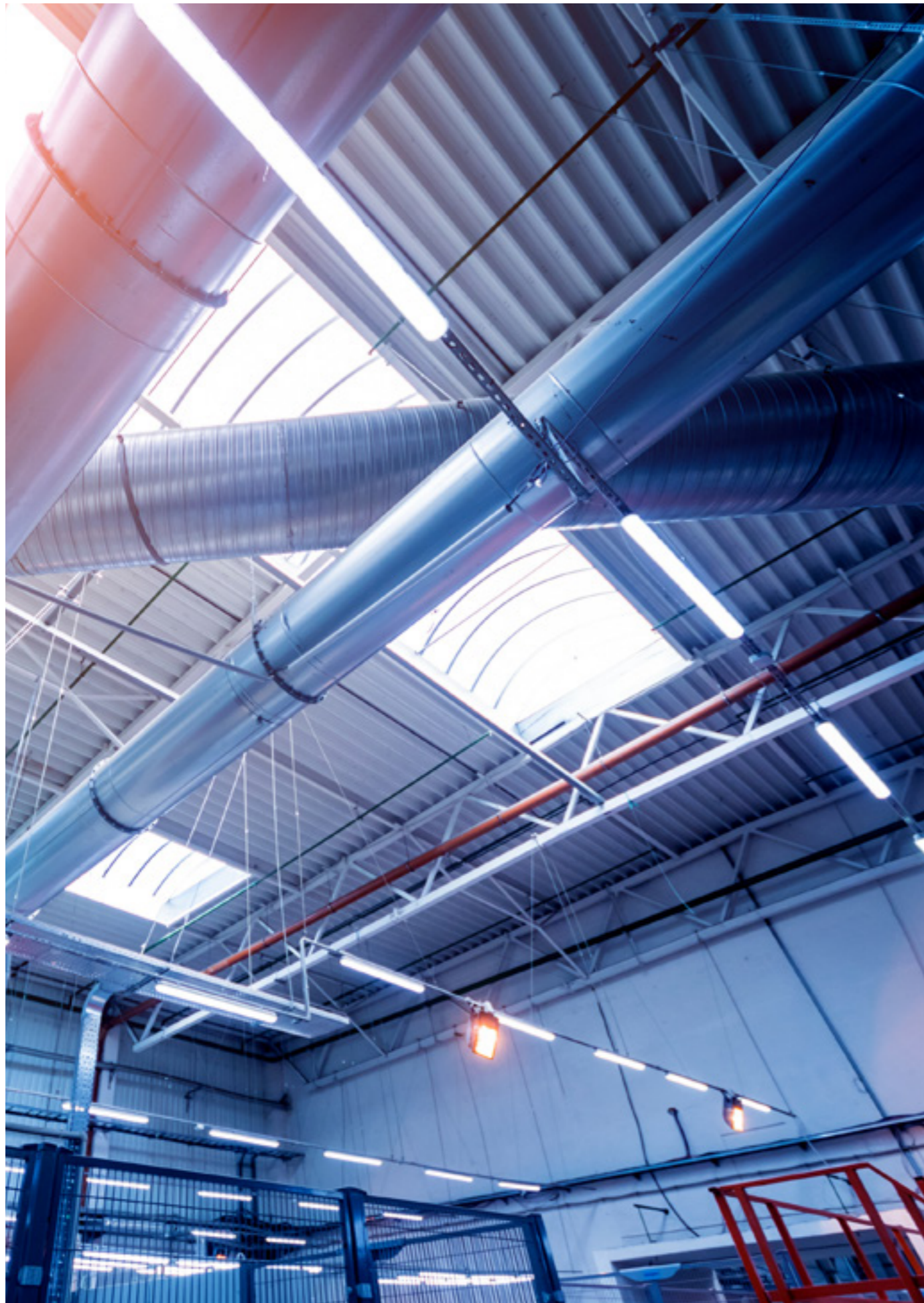
Einsatz von Tytan 2 LED Endura Leuchten in einer Lagerhalle
