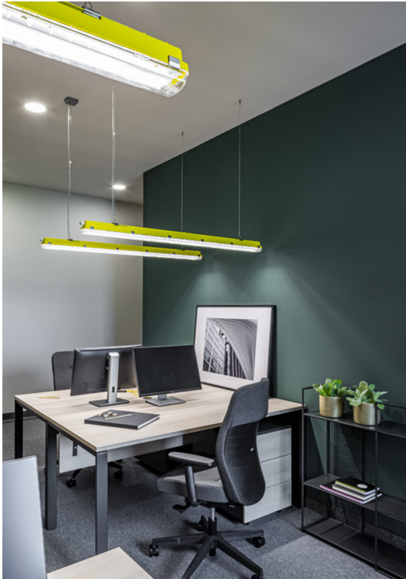
Einsatz von Tytan 2 LED UGR Leuchten in einem Büro
