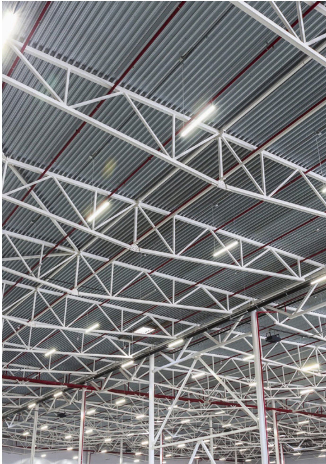
Einsatz von Tytan LED Multi Leuchten in der Lagerhalle
