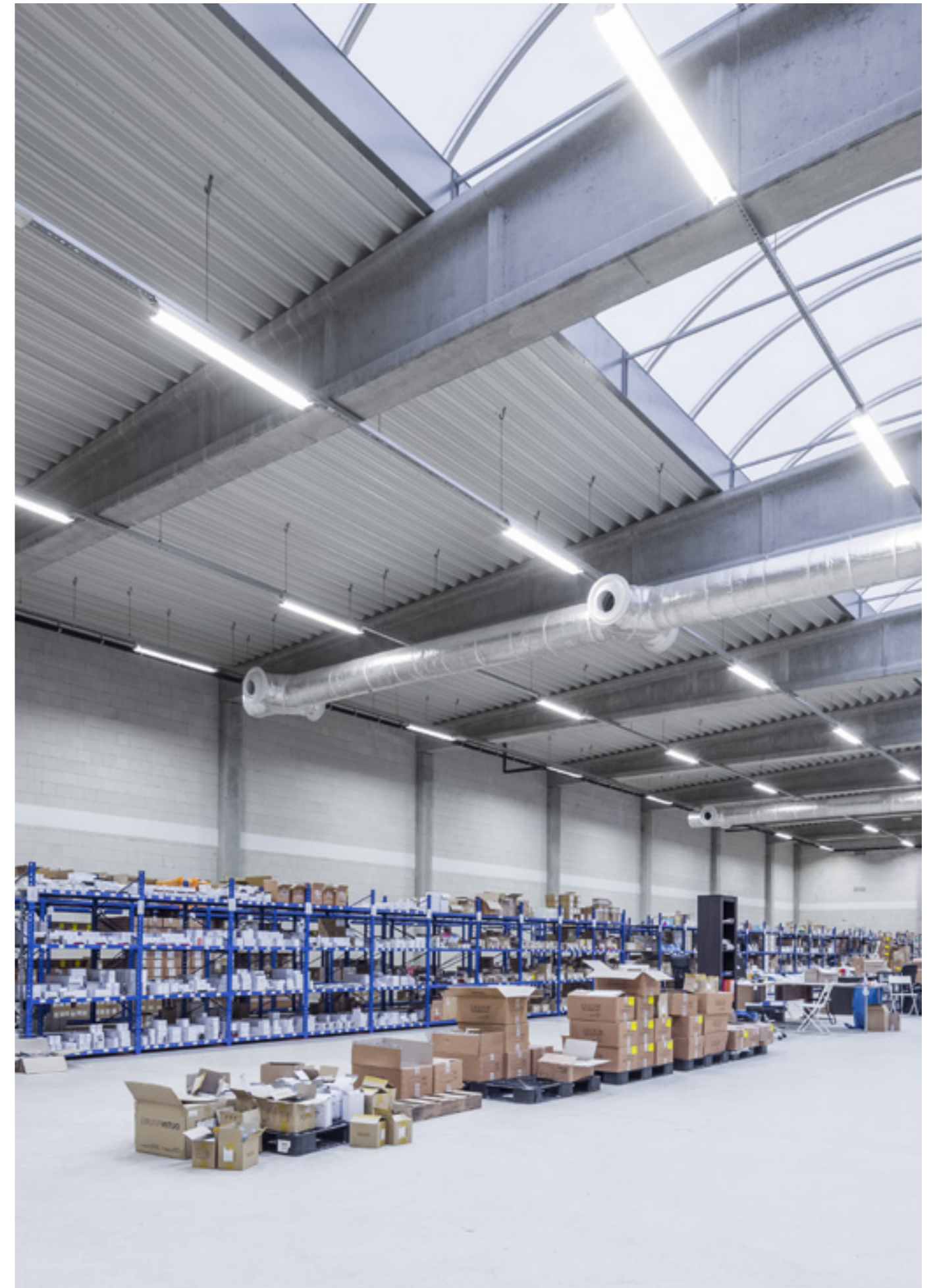
Einsatz von Titan Pro Leuchten in einer Lagerhalle
