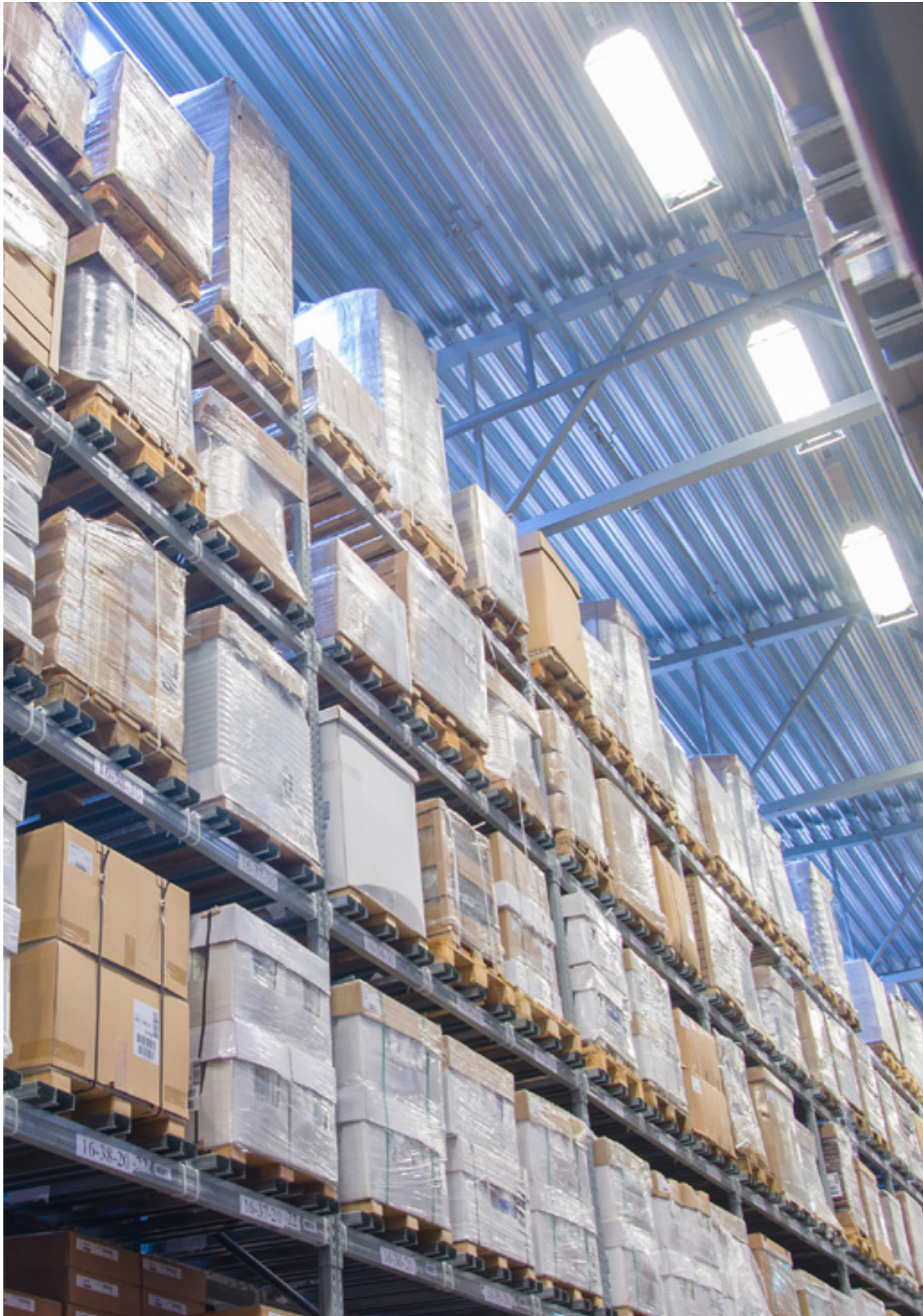
Einsatz der Industry 2 LED Leuchte in einer Lagerhalle.
